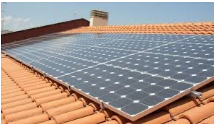
Impianto FV annesso
